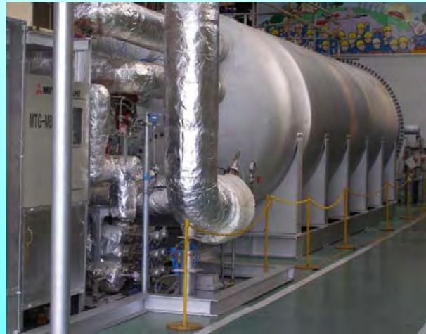
加圧形SOFC (NEDO委託研究 MHI報告書より)
