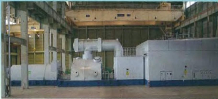
低圧蒸気タービン
