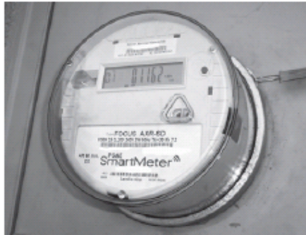
(a) 電力メーター
