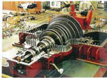
・蒸気タービン
