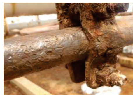
トレース蒸気配管
