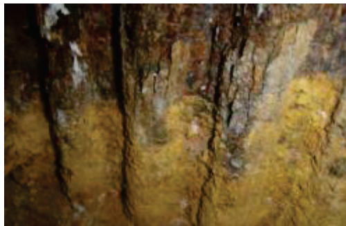
ボイラ/三次水壁管
