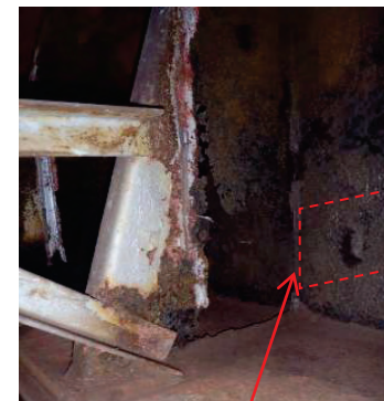
腐食による穴あき
