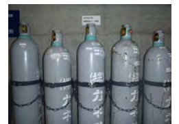
予備蓄電池 予備ポンペの配備
